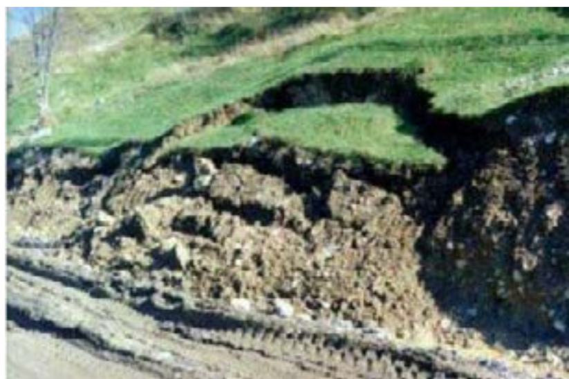
Fot. 4-2 Niestabilności lokalne spowodowane pracami ziemnymi
