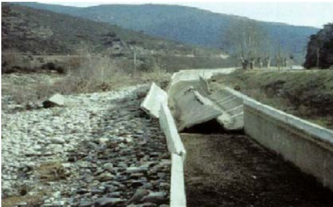
Fot. 4-12 Kanał uszkodzony przez ciśnienie filtracyjne wód spływowych
