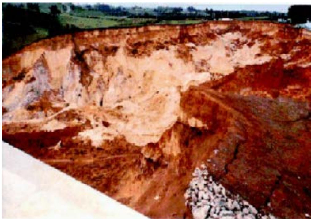
Fot. 4-8 Efekty infiltracji pod kanałem
