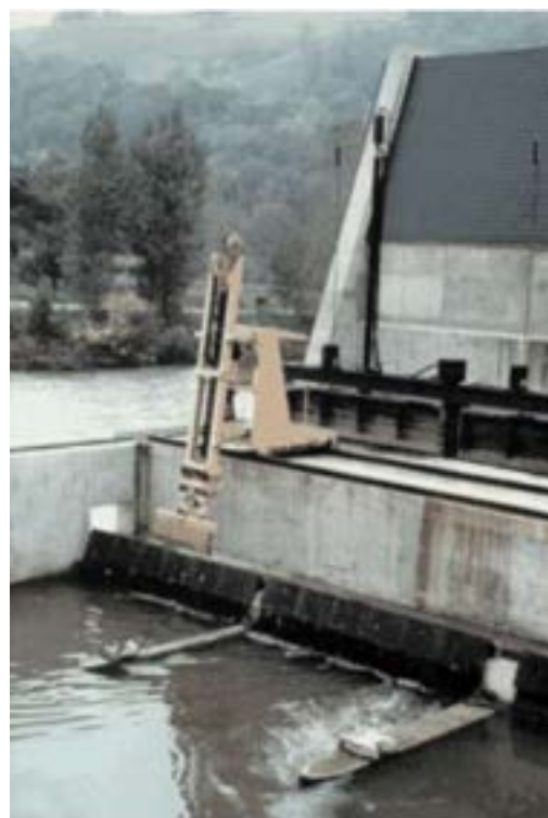
Fot. 5-16 Czyszczarka krat z hydraulicznymi siłownikami teleskopowymi
