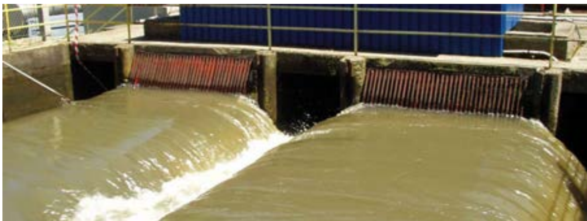
Fot. 5-11 Praca przelewów bocznych na kanałach doprowadzających wodę do MEW Skawina k/Krakowa podczas postoju elektrowni. Przelewająca się woda jest kierowana do kanałów upustowych pod budynkiem elektrowni
