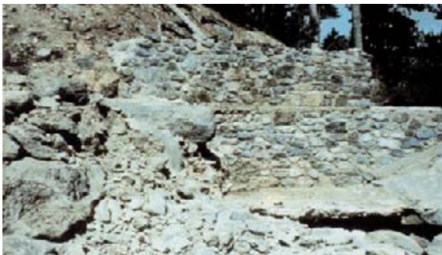
Fot. 4-11 Zaporę uszkodzoną przez sufozję
